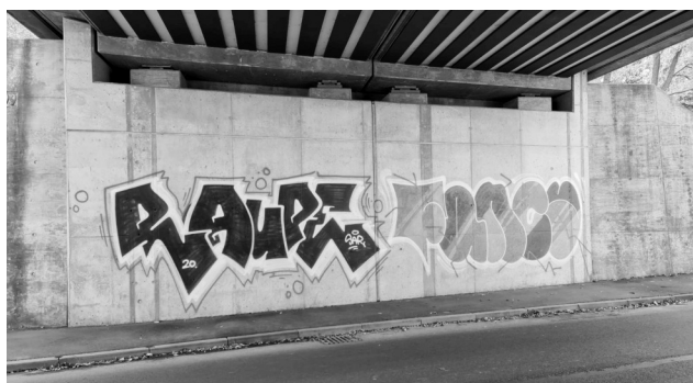
Leider eine von vielen Brücken mit Graffiti im Gemeindegebiet: Brücke in Geißlitz
