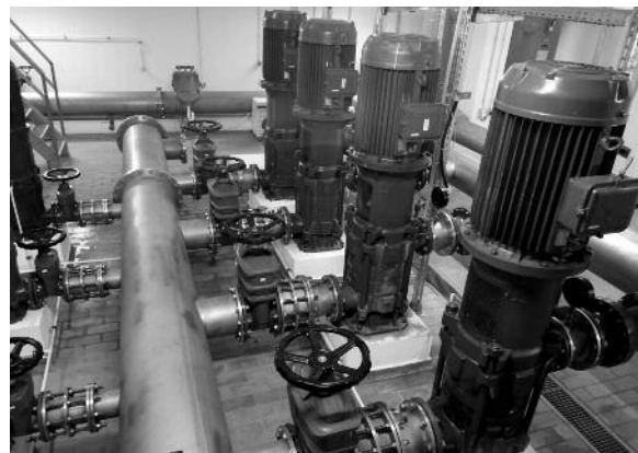
Die Druckerhöhungsanlage Großenhain-West vor dem Umbau.
